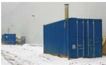
Контейнер-отопитель Polar HC 372 на объекте
