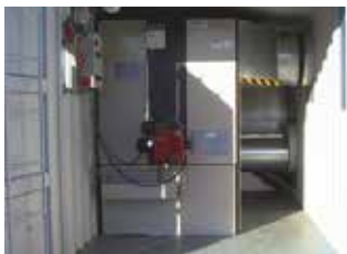
Контейнер-отопитель Polar HC 372, вид изнутри
